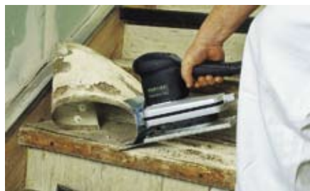
Bardzo przydatna na schodach ze względu na swoją poręczność.
